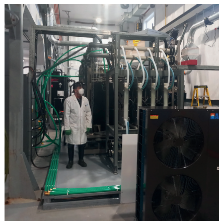
Usine d'électrolyte Vanadiumcorp n° 1 montrant le montage de l'électrolyseur au vanadium.
